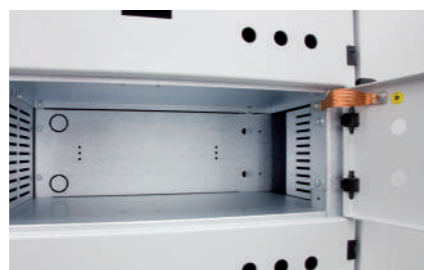
Compartiment armoire avec jeu de barres arrière: compartiment équipé avec plastron pivotant, platine de fond, séparation horizontale et séparation latérale en tôle Aluzinc®.
